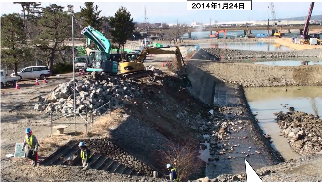
橘島 宇治川護岸(毎秒1500m 3 放流に対応して1982年完成)を壊している。
