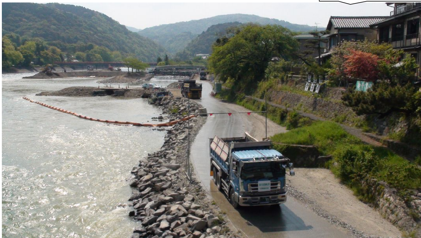
2013年秋～14年春(非洪水期)の工事が終了間際となり、護岸改変工事のための締切堤の鋼矢板が抜かれ、締切の土砂をダンプカーで続々と搬出しています。次の工事は2014年秋に再開されます。
