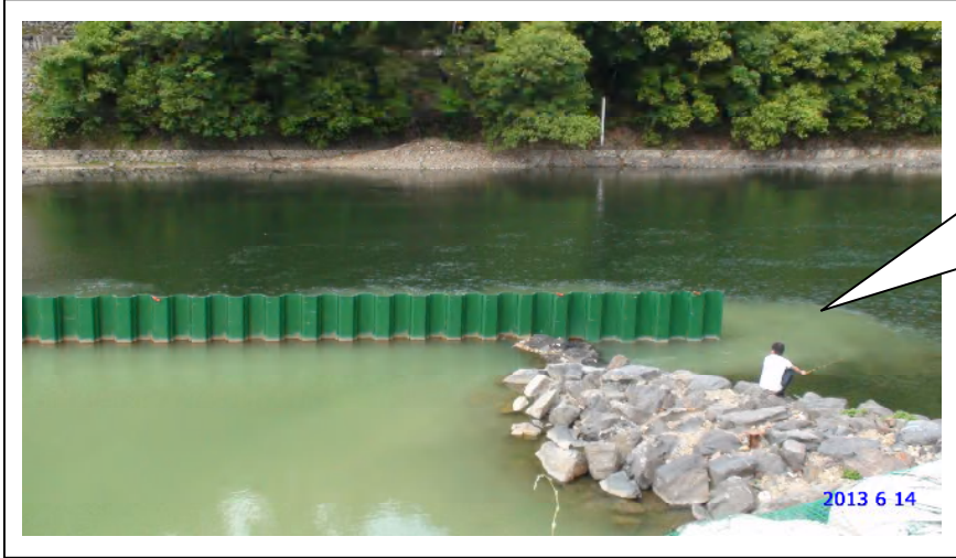
写真1 2013年6月14日 鋼矢板締切の上流端 汚濁水が締切部分から本流へ流れ 出し、水質汚染・汚濁が広がっている。 これ自身が水質汚濁防止法違反の 恐れ。
